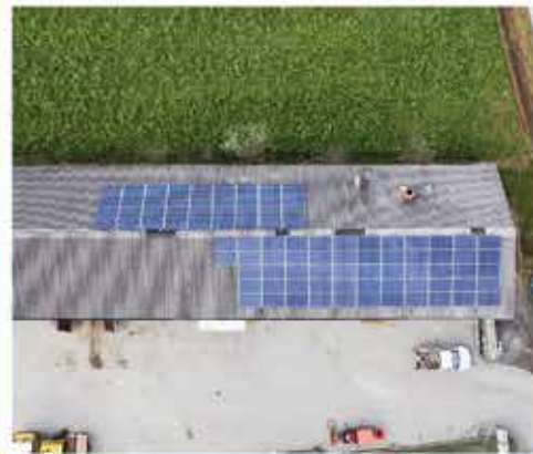
z. B. PV-Anlage: Bauhof Karlstein
